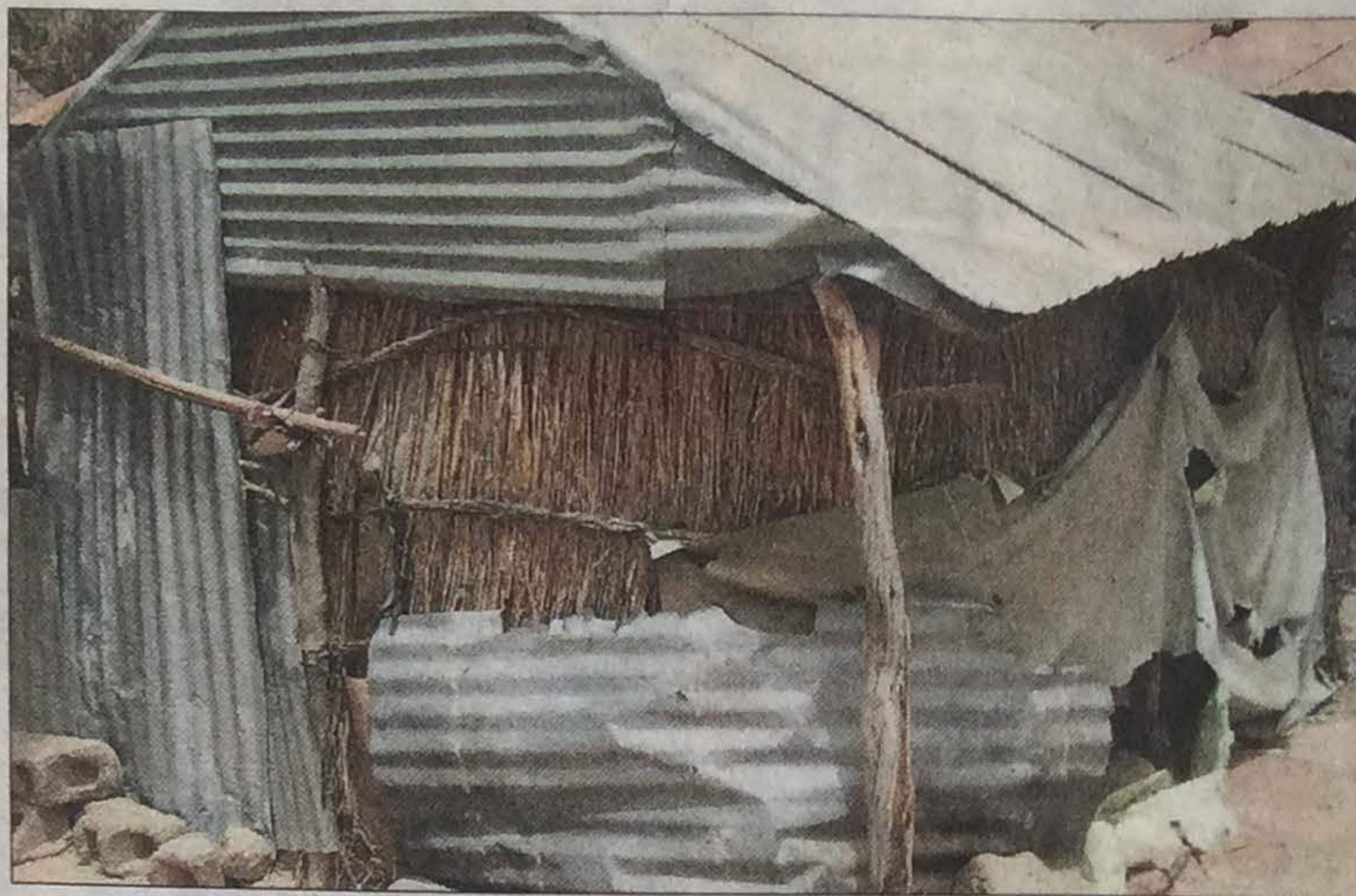
Die Strohütten der Bewohner des Lepradorfs Darou Salam werden buchstäblich von Termiten aufgefressen und können von den Bewohnern nur notdürftig geflickt werden.
