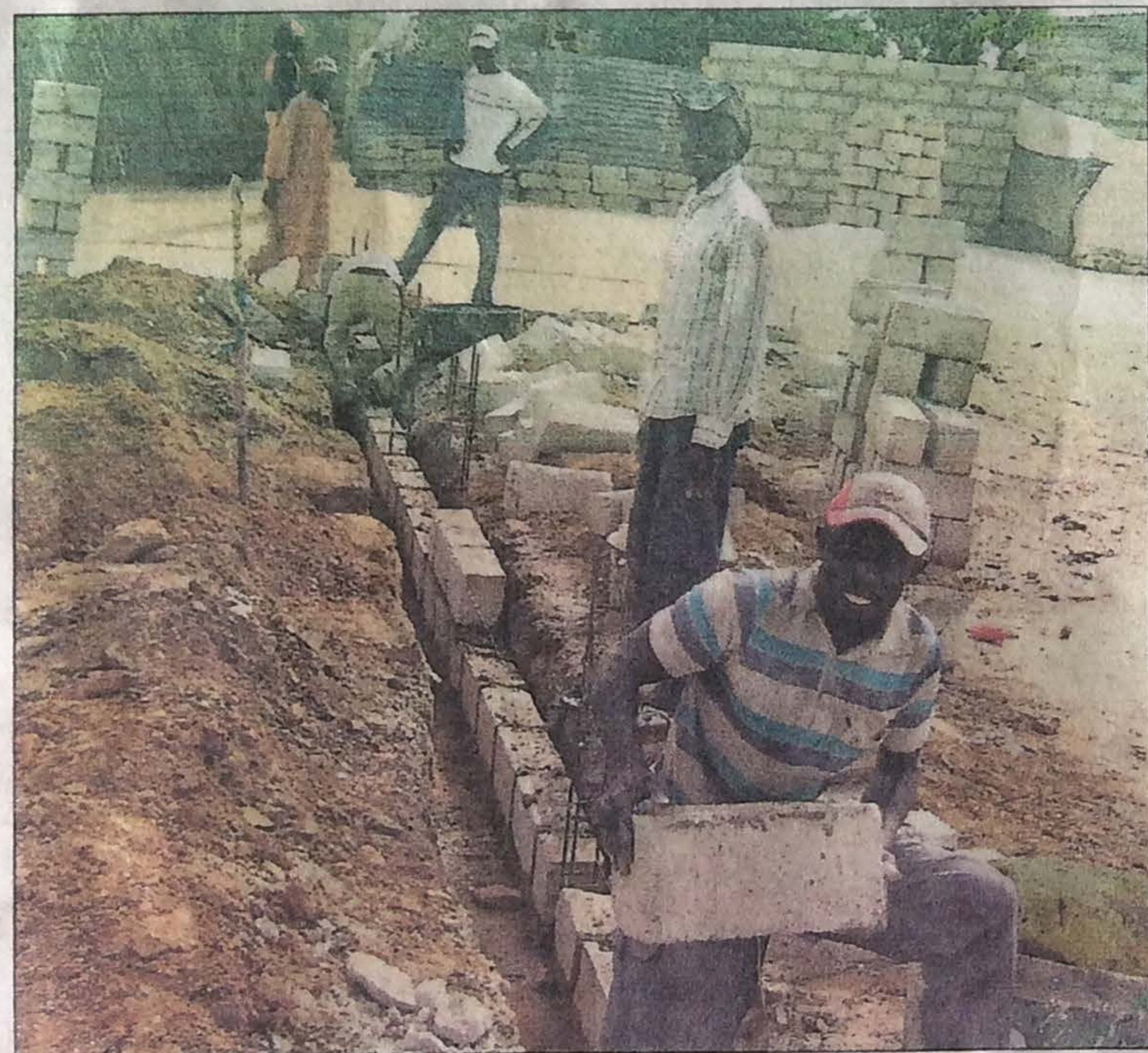
Auf dem Grundstück, das die grenzenlose Leprahilfe von der Gemeinde zur Verfügung gestellt bekam, wird eifrig gebaut.
